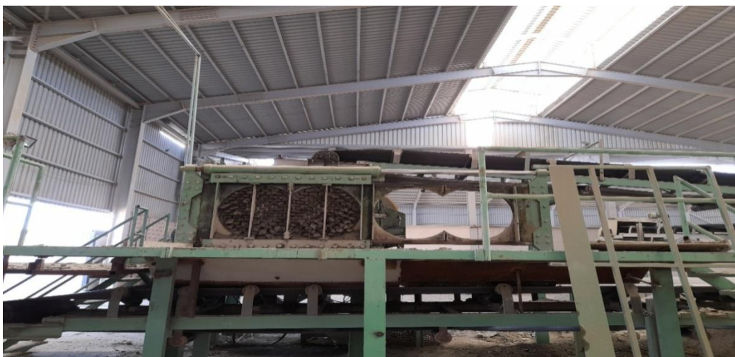
Figure 20 : Malaxeur de criblage
