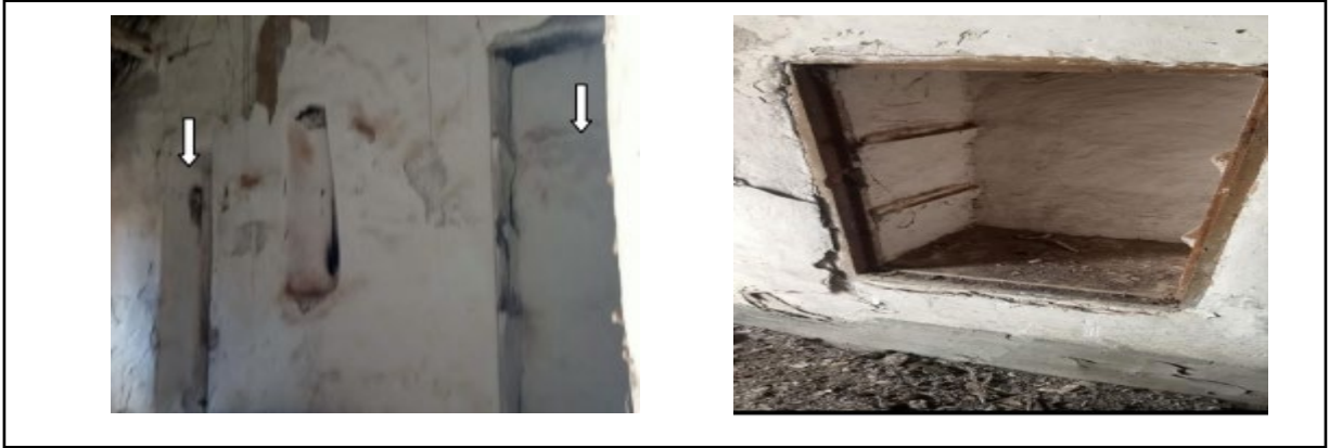
الملحق رقم 06: أشكال الخزائن داخل المطابخ
