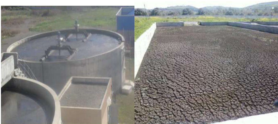
Figure n° 15: épaisseurs de boue
