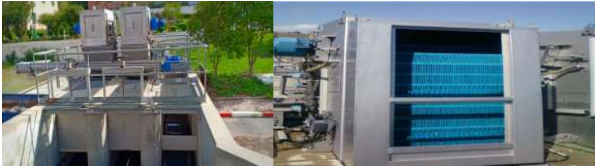
Figure n°06 : Dégrillage fin automatique figure n° 07: Dégrillage grossier
