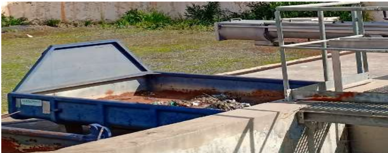
Figure n° 08: Benne pour déchets grossier
